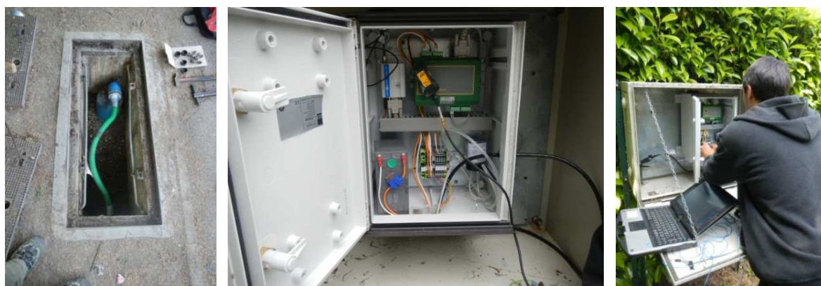
Figure 4 : Le site de Champdeuil avec la cloche étanche où passe la sonde OTT PLS (à gauche), le caisson étanche avec la station d'enregistrement (au centre) contenue au sein de l'armoire métallique extérieure (à droite).
