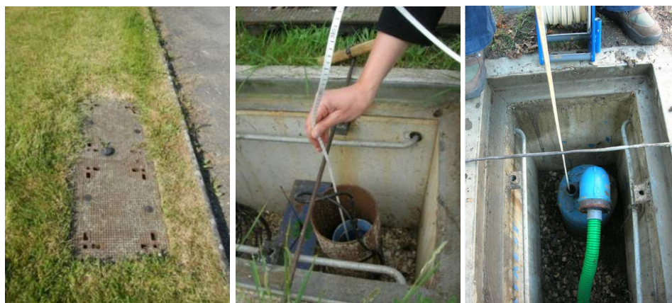
Figure 2 : Les plaques de fonte du regard béton (à gauche), une mesure du niveau dans le tube du forage (au centre) et dans la cloche du forage à Champdeuil.
